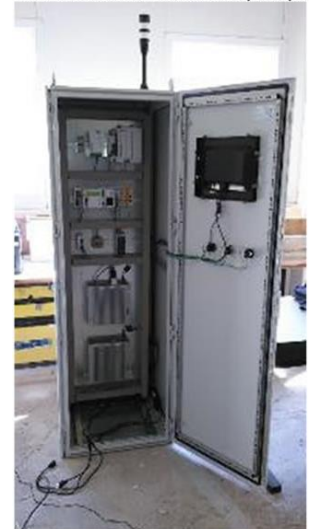
Ensamble de sistema de control principal
